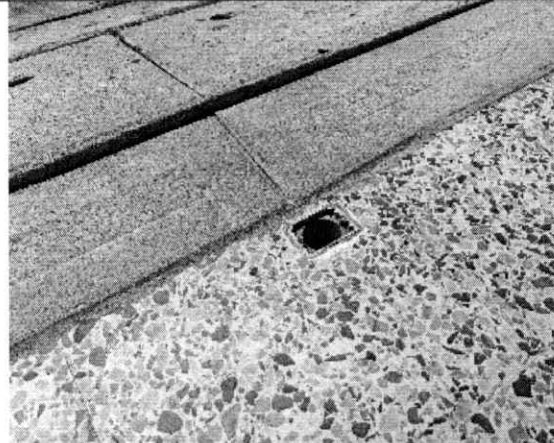
Fotografía 1. Rejilla metálica de piso primer piso en mal estado.
