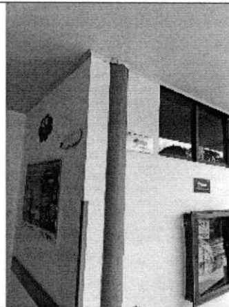
Fotografía 20. Filtración de agua lluvia en servicio de Urgencias.
