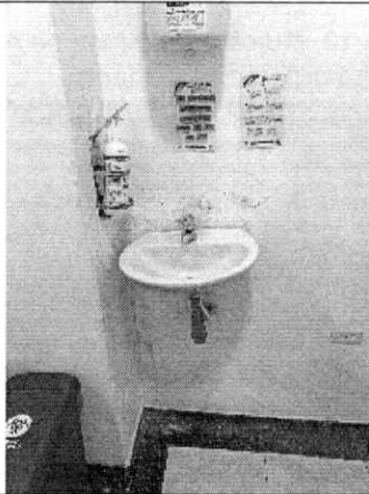
Fotografía 19. Muro servicio de Urgencias en mal estado.
