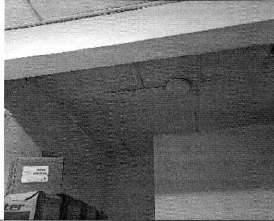
Fotografía 7. Cielo raso de Almacén General en mal estado.
