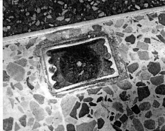
Fotografía 2. Rejilla metálica de piso primer piso en mal estado.
