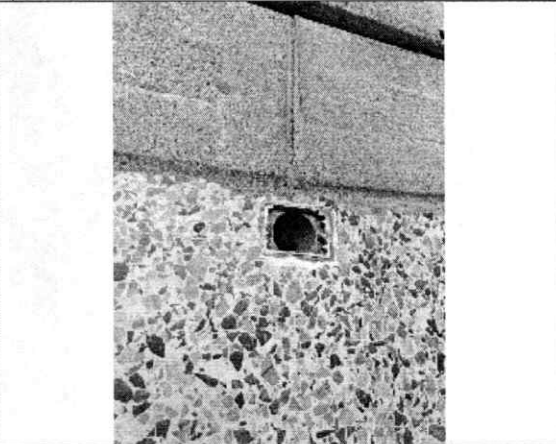
Fotografía 4. Rejilla metálica de piso primer piso en mal estado.
