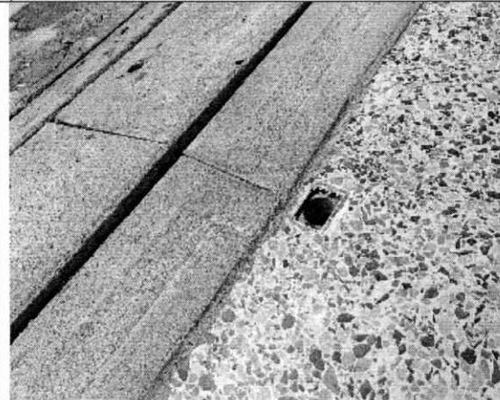
Fotografía 3. Rejilla metálica de piso primer piso en mal estado.
