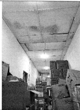
Fotografía 8. Cielo raso de Almacén General en mal estado.
