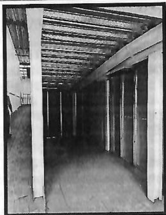
Fotografía 1. Espacios en condiciones tales que se requiere la instalación de muros y cielo rasos.
