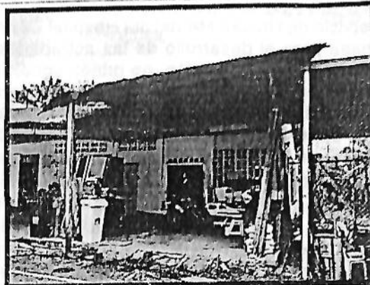
Fotografía 3. Evidencia del deterioro de la cubierta adosada a la oficina de Mantenimiento Hospitalario.
